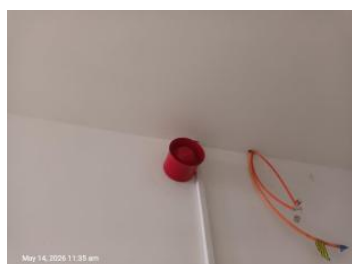
Fire alarm bell.jpg
